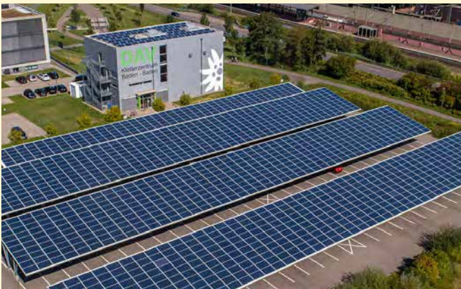
Park&Ride-Parkplatz der Stadtwerke Baden-Baden mit 371,3 kWp Photovoltaik
