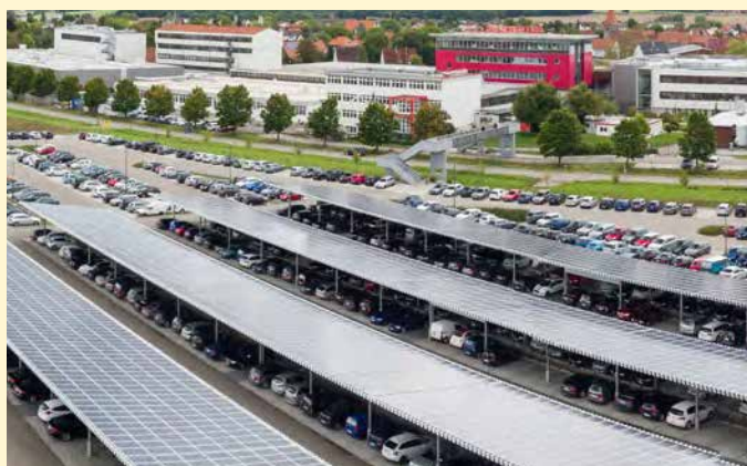
Photovoltaik-Parkplatz des Maschinenbauunternehmens Bausch+Ströbel in Ilshofen
